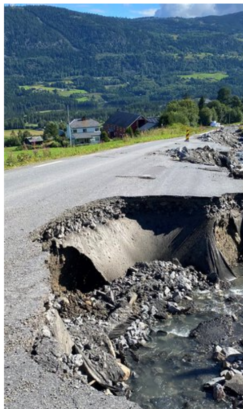
Hele fylkesveg 2874 Mønavegen i Nord-Aurdal fikk store skader på grunn av uværet «Hans» i august 2023.
