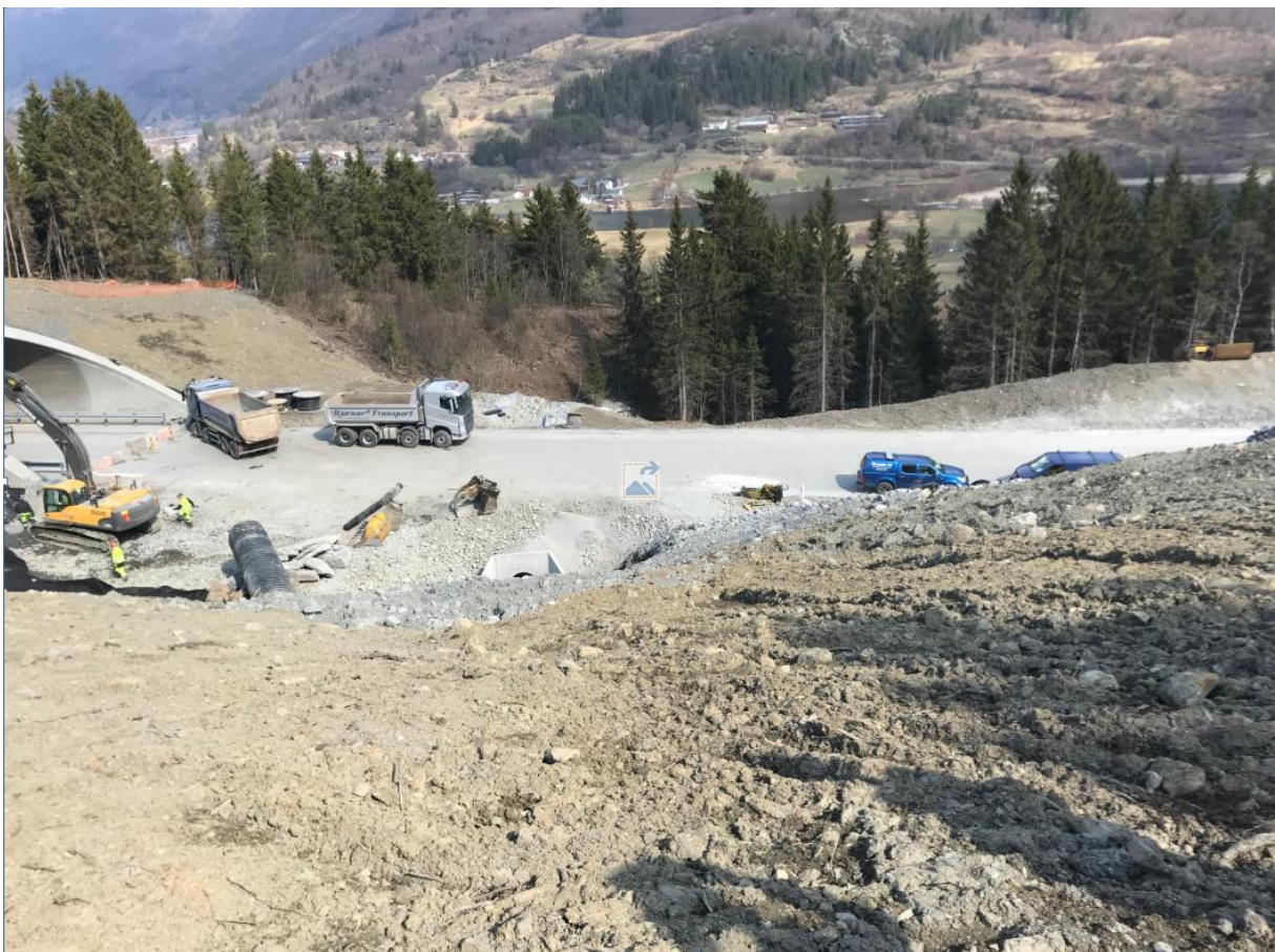
Figur 8 - Nedføring mot drenering og veg som det var 24.4.19. Foto: S. Aalbu, SVV
